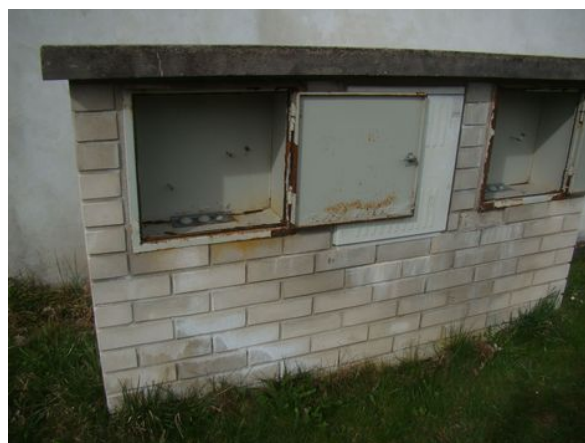
Nefunkční přívod elektro
